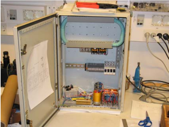
Bild .17 Reläskåp med relän trafo och säkringar
