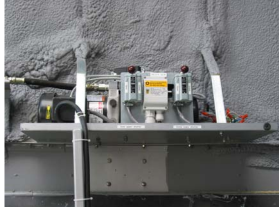
Bild .18 Motorstyrning innan ombyggnad med brytare direkt på motorn
