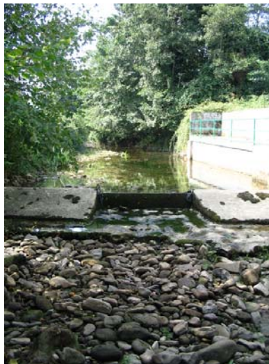
Figura 4.58. Toma de agua para el abastecimiento de Castro Urdiales, en la que se observa el río seco aguas abajo del azud.
