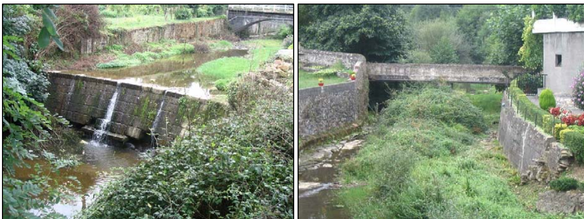
Figura 4.54. Azud y puente localizados en el término de La Matanza. Se observan los encauzamientos existentes.
