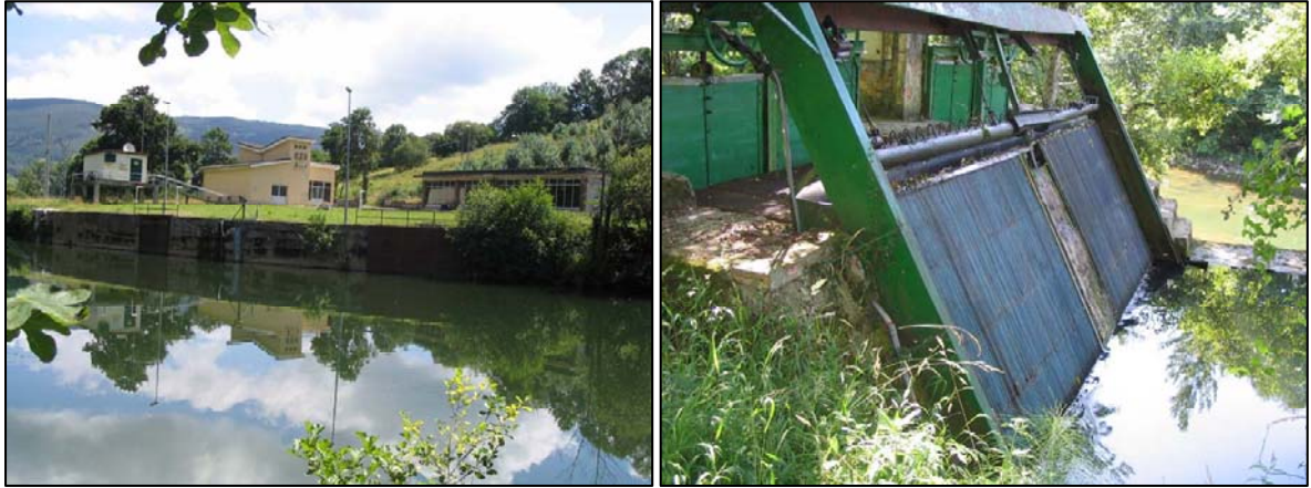
Figura 4.52. Toma de abastecimiento del Plan Asón (izquierda) y de una central hidroeléctrica (derecha), ambas aguas arriba de Ampuero.
