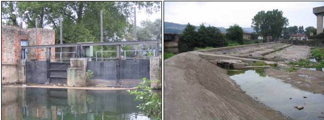
Figura 4.32 . Azud y toma en los Corrales de Buelna, en la que se observa el cauce prácticamente seco.
