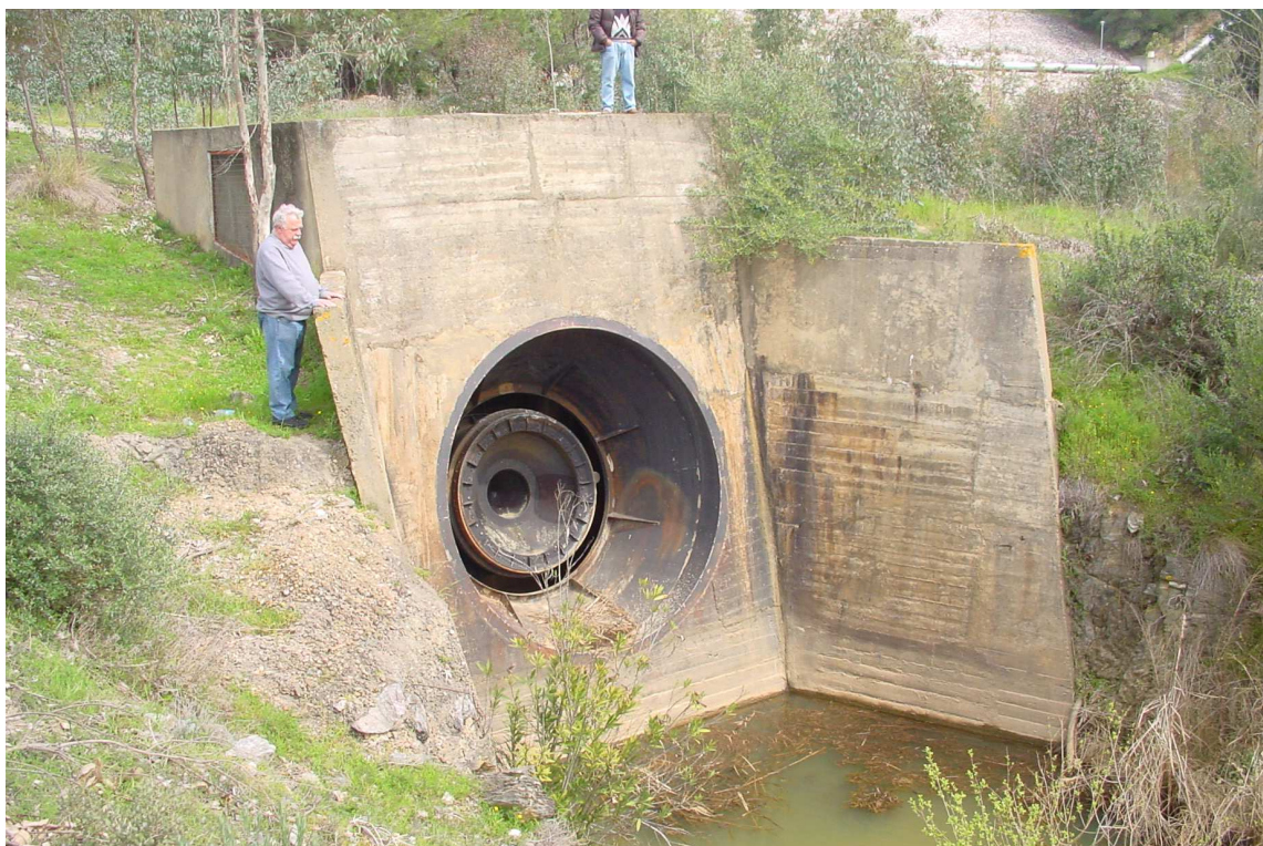
DESCARGA DE FUNDO
