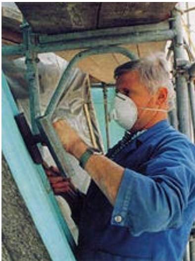
Da sich bei der Verarbeitung des vorpatinierten Kupferblechs Patinapartikel lösen können, müssen die Spengler bei der Arbeit eine Schutzmaske tragen.
