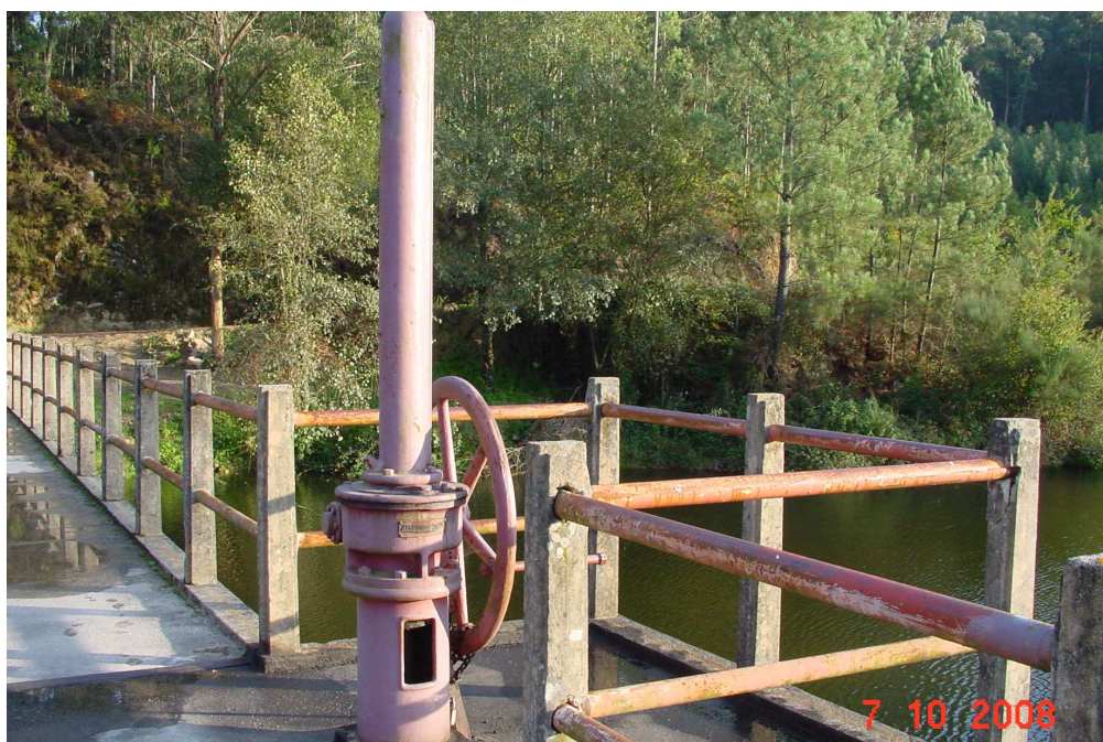
DESCARGA DE FUNDO
