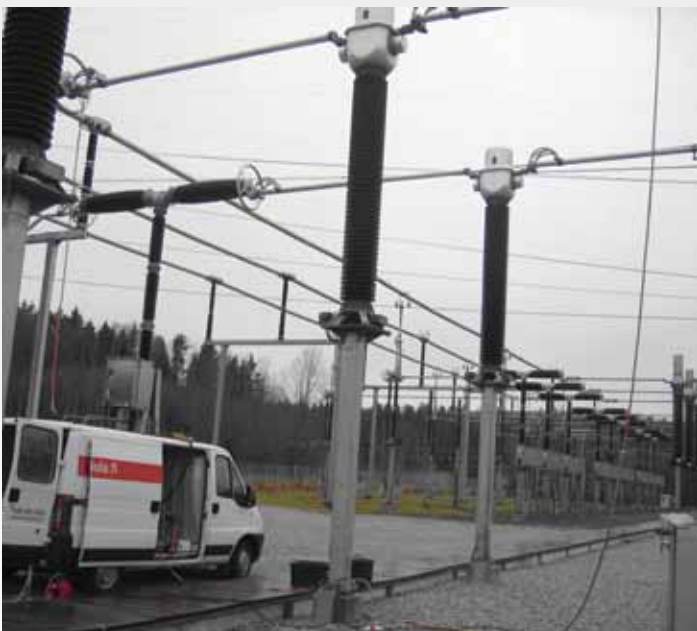
Kuva 2. Virtamuuntajien kalibrointia niiden käyttöpaikalla, 400 kV sähköasemalla.
