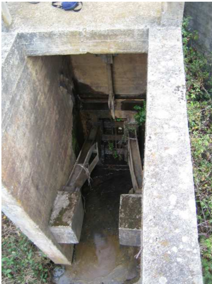
DESCARGA DE FUNDO
