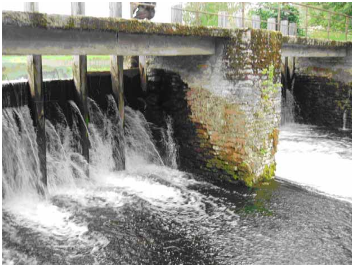
Foto 2. Kaldasamba kahjustused (pildi autor Rain Elken)
