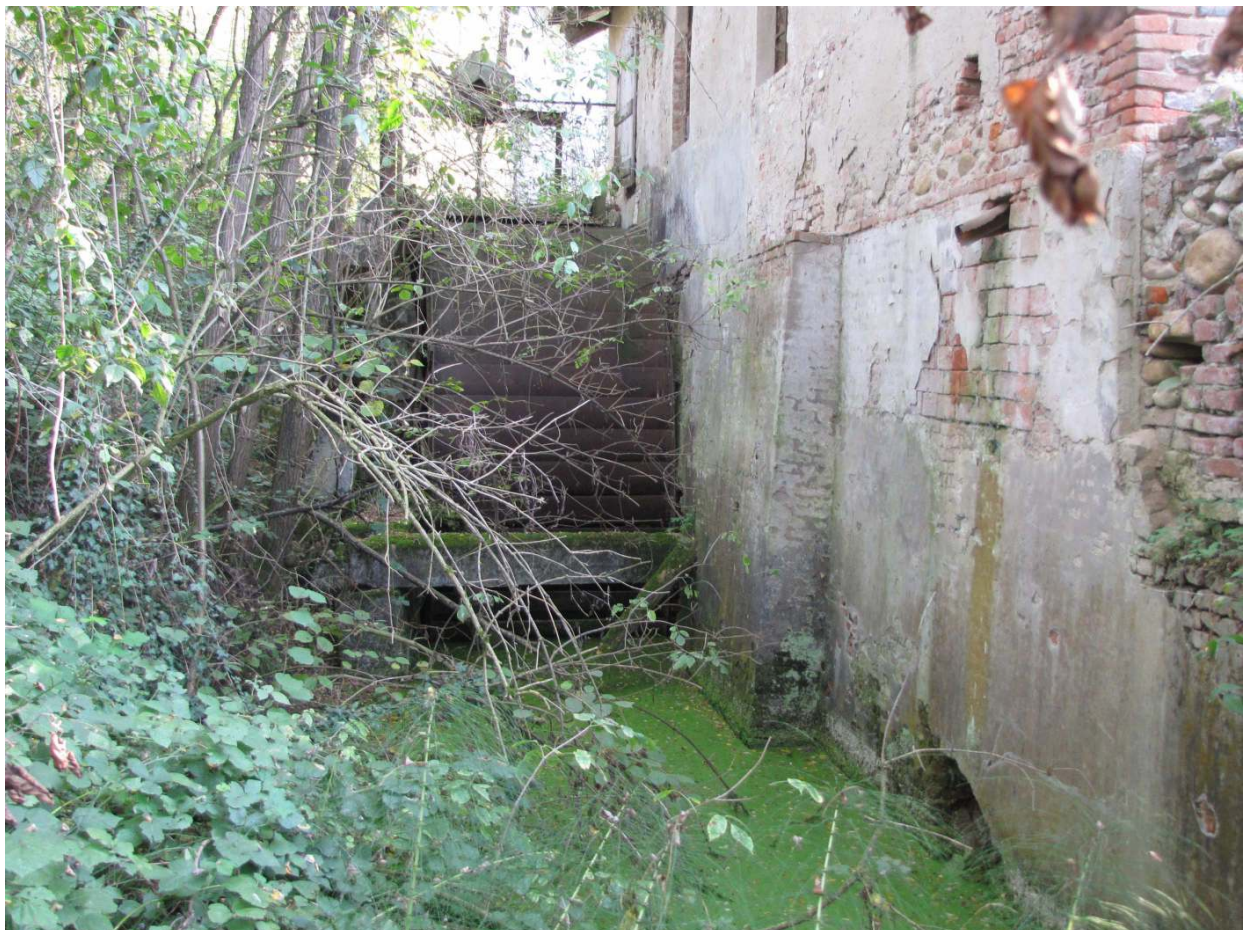
Figura 11: zona di realizzazione vasca di carico condotta forzata , sgrigliatore, paratoie di regolazione e inizio canale di scarico.
