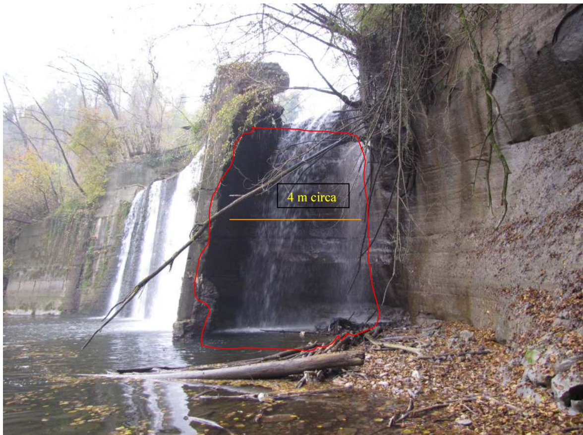
Figura 7: zona della briglia scalzata in sponda sinistra.
