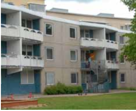
Miljonprogramsområde i Norrköping. Fasadelement med sjöstensyta, balkongfronter av betong. Foto Lars Ekelund
