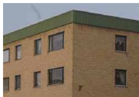
Hus med plana tak där takfoten döljs bakom en sarg av av plåt eller träpanel är typiskt för 1960-talet. Västanågatan Linköping.
