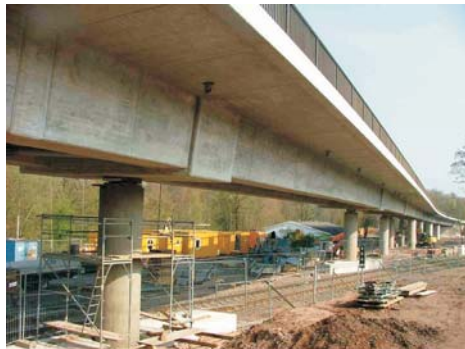
Schwarzbachtalbrücke im alten Zustand (Bild oben) und nach den Arbeiten mit einem neuen Überbau (Bild unten)
