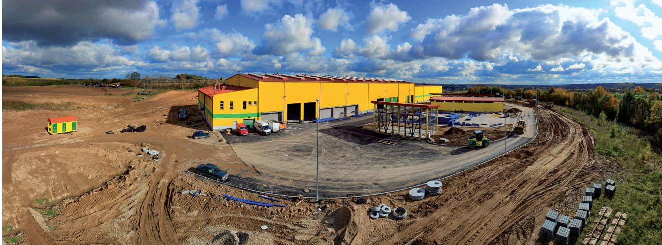
Budowa Zakładu Unieszkodliwiania Odpadów Komunalnych w Siedliskach k. Elku. Fot. Zbigniew Bieleniewicz
