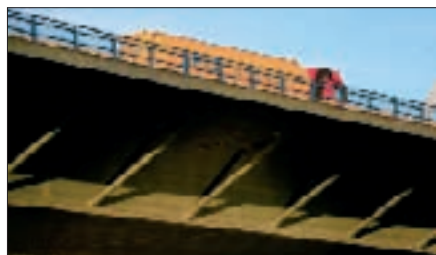
4. kép: Alulnézetben jól látható a mederhíd szerkezeti szerkezete és a járdakonzolok
