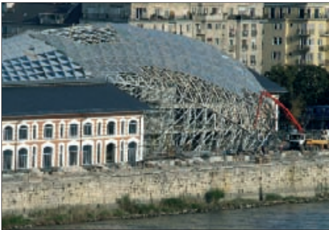
26. kép: A csarnok a homlokzatépítés befejezése előtt. Jól látható a divatos szerkezet vasbeton maghoz kötött acél tartószerkezetre erősített panel-üveg és alumíniumelemeket tartó homlokzat kialakítás
