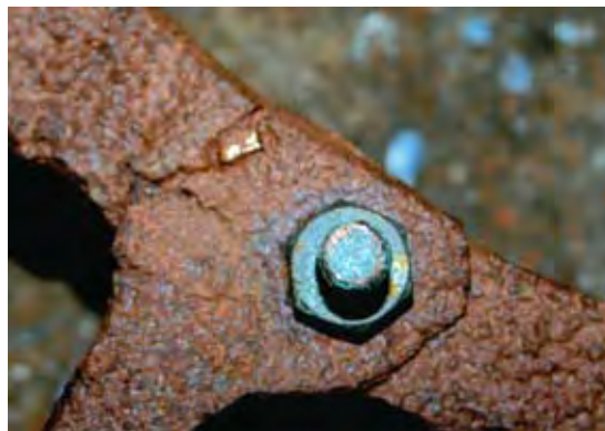
◀ Korrosionsschäden in der Stützkonstruktion
