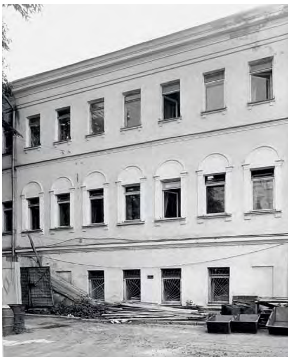
Фрагмент главного фасада дома до реставрации. 1989 г.
