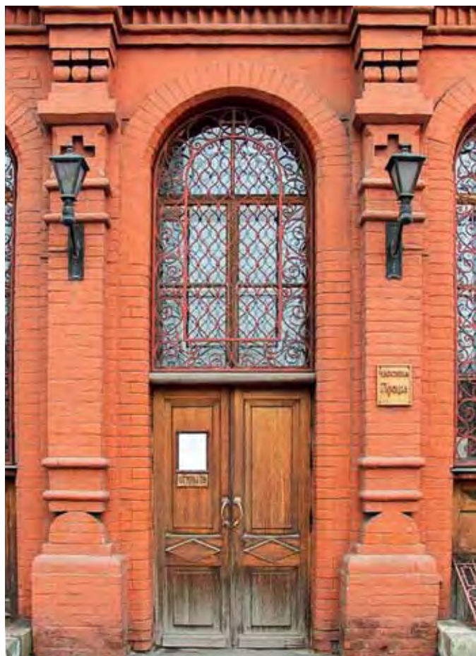
Фрагмент фасада часовни с входной дверью до реставрации
