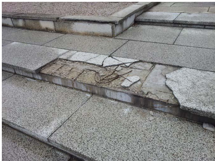
Schody prowadzące na górny taras cmentarza wojennego w Puławach stan przed naprawą
