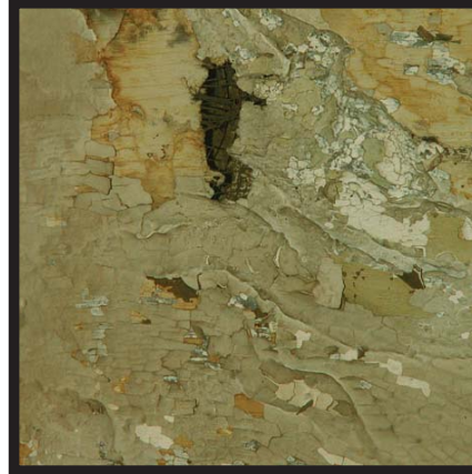
(d) erosion of metal fasteners
