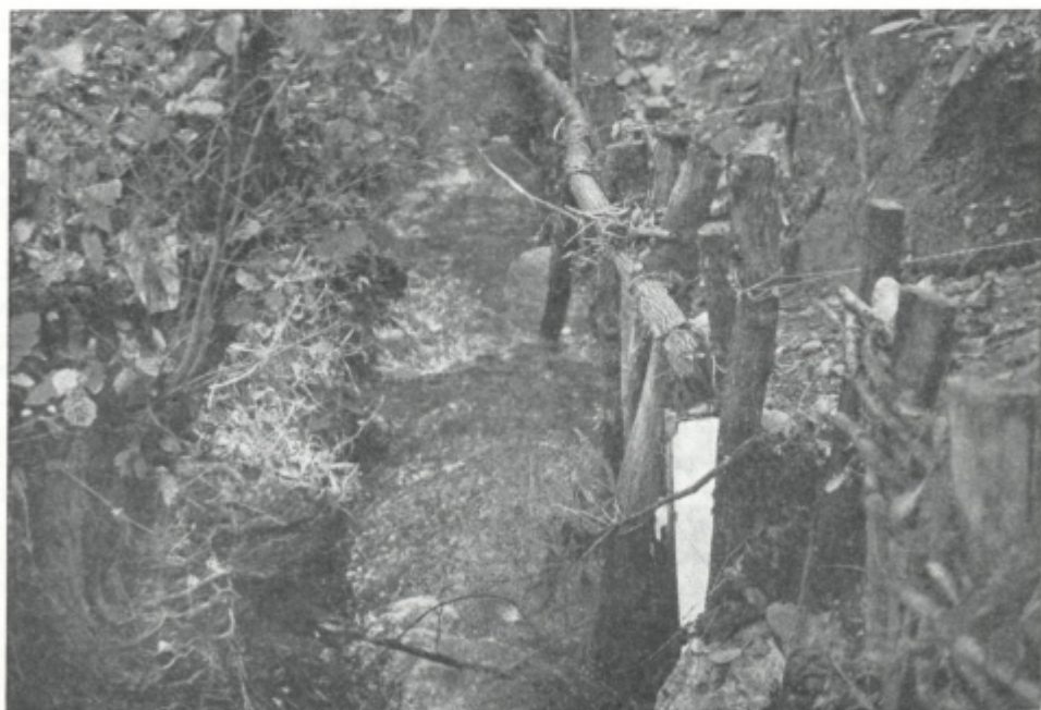
Sl. 15. Zaplaninščica, desni pritok Bolske na Ločici pri Vranskem. Tudi v njeni strugi so številne naprave, ki varujejo bregova pred rušilnimi učinki naraslih voda
