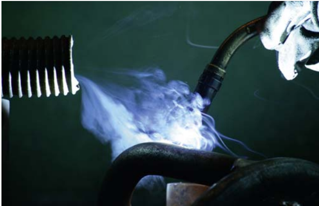
Die Absaugung von Gasen, Rauch und Stäuben beim Schweißen gehört zum Arbeitsschutz.
