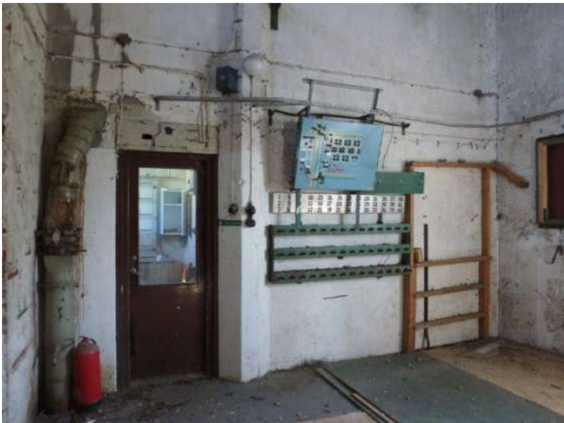
Foto Kulturen. I maskintornets mitt på första våningen. Dörren leder in till manöverrummet. Den övre tavlan är den nyare elektriska manövertavlan av luckorna i lanterninen och den nedre den manuella övervakningstavlan.
