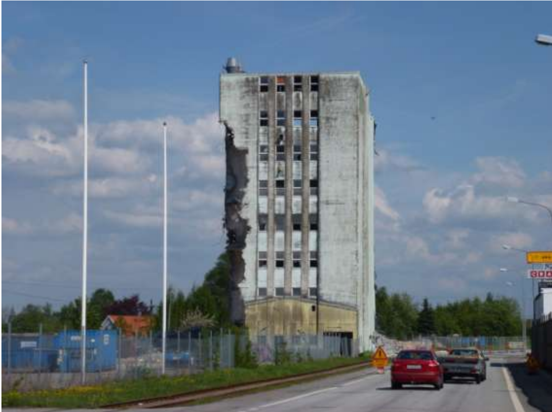
Foto Kulturen 2012. Vy från söder. Maskintornet är naggat i kanten och den rikliga armeringen i betongen är synlig.
