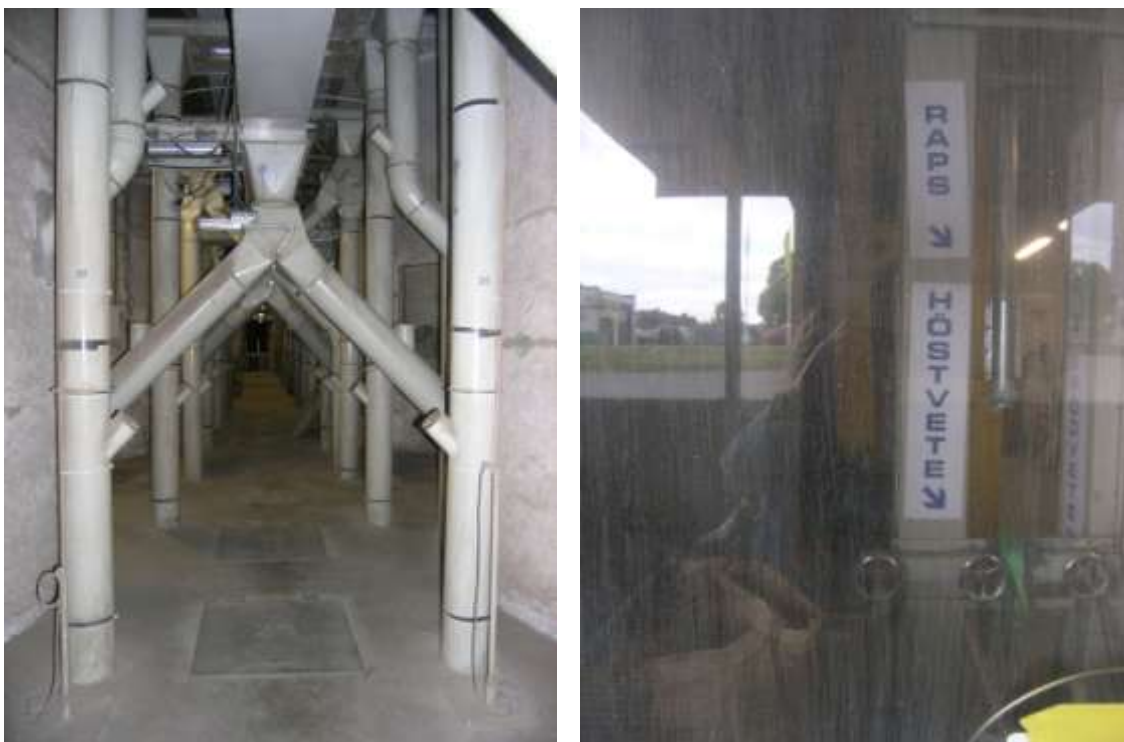
Foto Regionmuseet Kristianstad: Till vänster gång mellan siloceller och rörsystem för transport av spannmål. Till höger inblick genom fönstret till siloanläggningen, där rattar för olika produkter reglerar vilken vara kunden får med sig.
