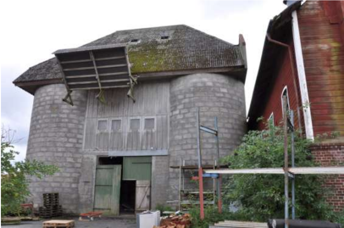
Foto Helen Carlsson, Höörs kommun: Silon i sommarskrud. Vy från nordväst med silobyggnaden och det intilliggande magasinet.
