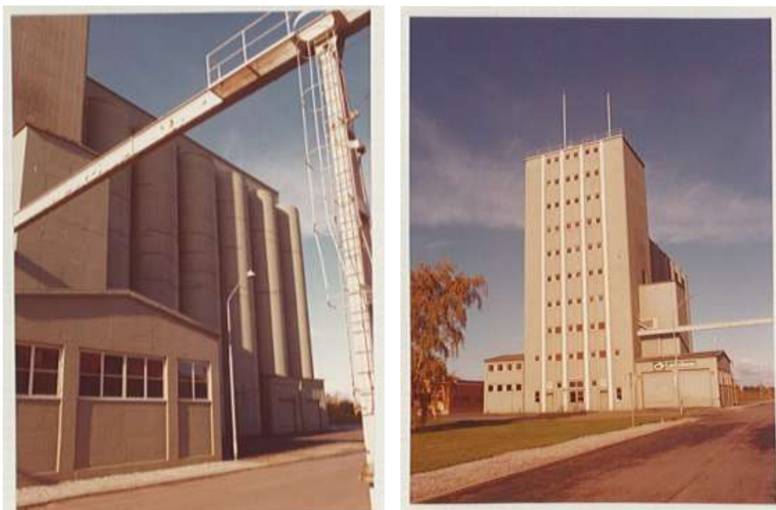
Foto: Lantmännen, årtal okänt. Här är anläggningen i drift. Betongsilorna är ännu inte plåtinklädda men horisontella sprickor är synliga. Höger: Maskintornet med vita band i betongen.
