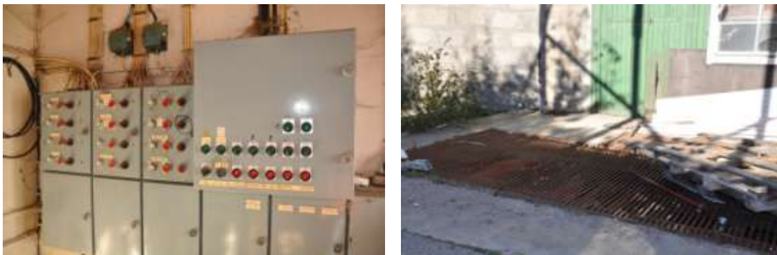
Foto Helen Carlsson, Höörs kommun: Till vänster kontrollpanel för silon och till höger inlastningsficka till silon.
