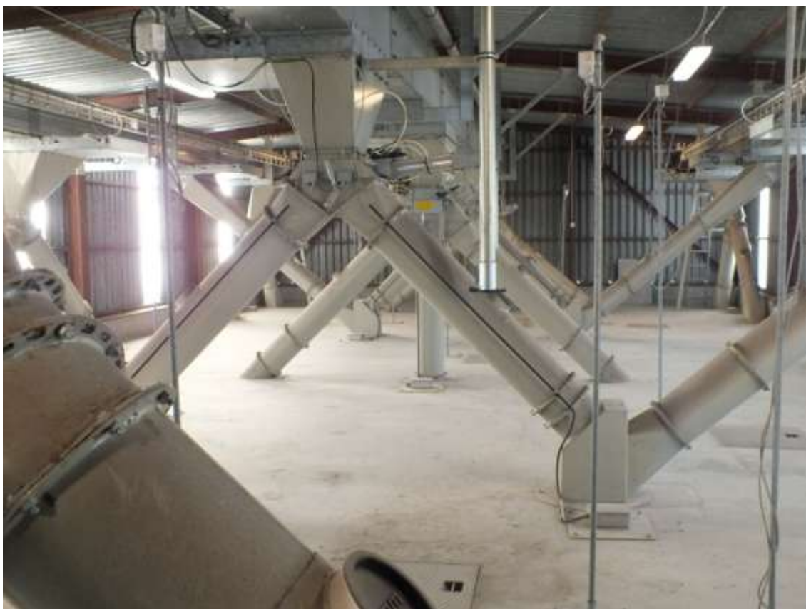
Foto Regionmuseet Kristianstad: Rum ovanpå silocellerna med processutrustning i form av transportanordningar som fördelar de olika fraktionerna mellan silocellerna. Fördelningen är numera helt digitaliserad i Karpalund.
