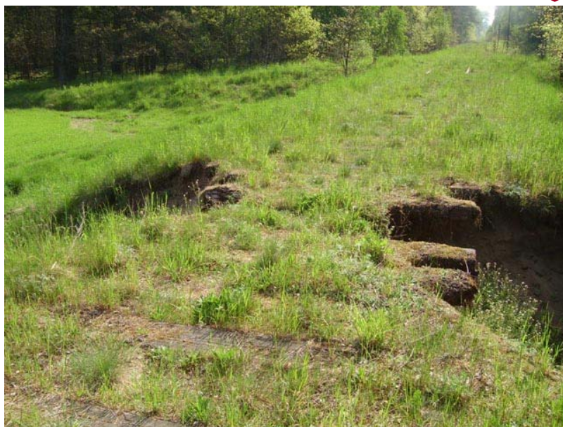
Fot. 28: Kradzieże betonowych kręgów służących za przepusty to plaga na linii nr 212 – km 49,500, maj 2007 roku
