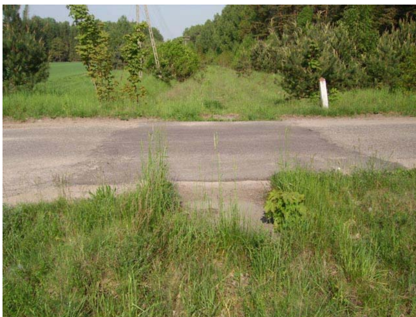
Fot. 34: Zalany asfaltem przejazd na drodze Drażkowo - Cetyń, maj 2007 roku
