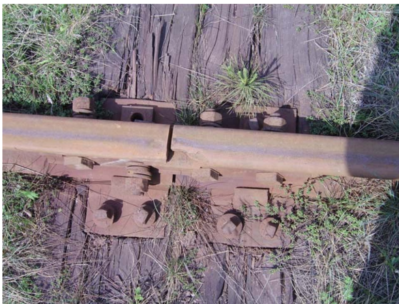
Fot. 13: Mocno zmurszałe podkłady pod stykiem toru typu 8, maj 2007 roku
