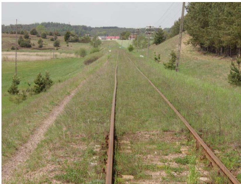
Fot. 8: Stan toru na linii nr 212 pozostawia wiele do życzenia – km 5,000, maj 2007 roku.
