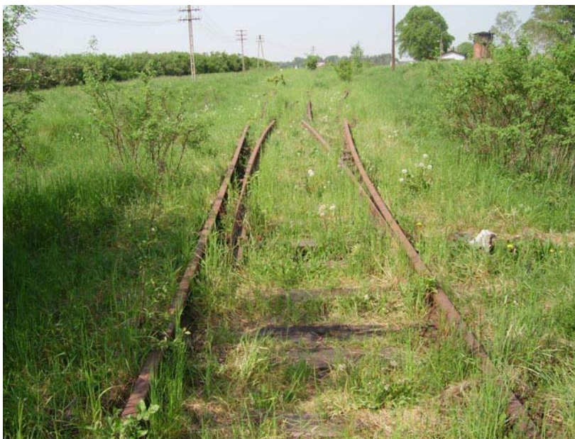
Fot. 30: Braki szyn w rozjeździe na wjeździe do Zielina Miastecckiego od strony Bytowa, maj 2007 r.
