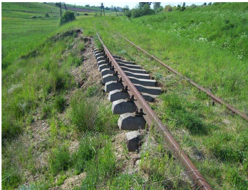
Fot. 22: Podmycie toru w km 29,700 koło Dąbrówki Bytowskiej, maj 2007 roku
