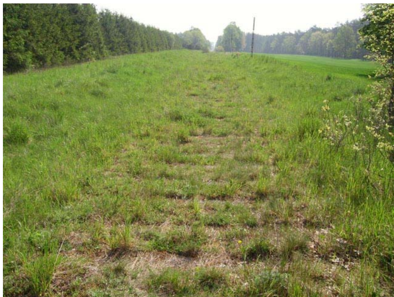
Fot. 1 Całkowity brak szyn, podkładek, przytwierdzeń i łubków w okolicy km 50,000, maj 2007 roku
