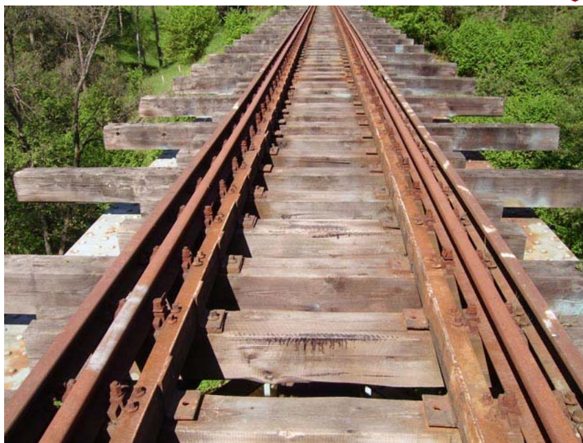
Fot. 25: Most nad rzeką Kamienną pozbawiony barierek ochronnych , maj 2007 roku
