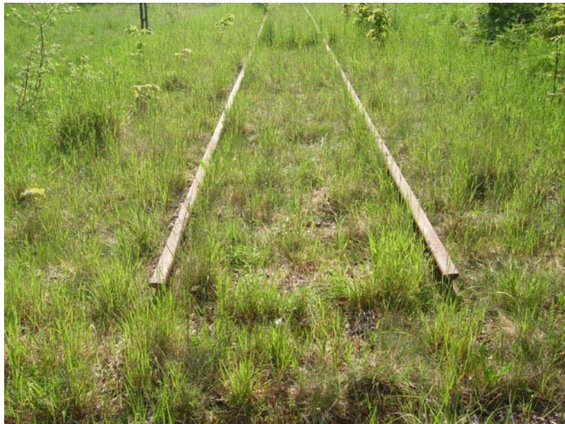
Fot. 27: Początek odcinka z ukradzioną nawierzchnią – km 48,400, maj 2007 roku
