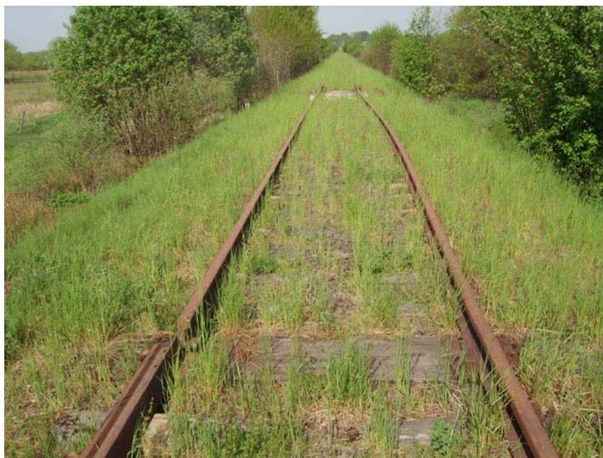
Fot. 26: Brak przytwierdzeń szyn do podkładu, maj 2007 roku
