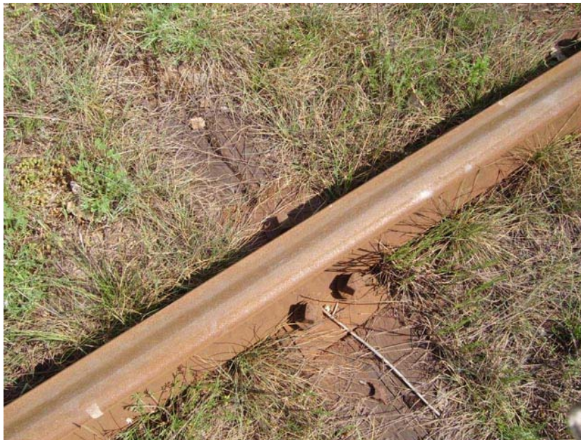
Fot. 15: Przytwierdzenie bezpośrednie szyny typu 8 do podkładu drewnianego, maj 2007 roku.
