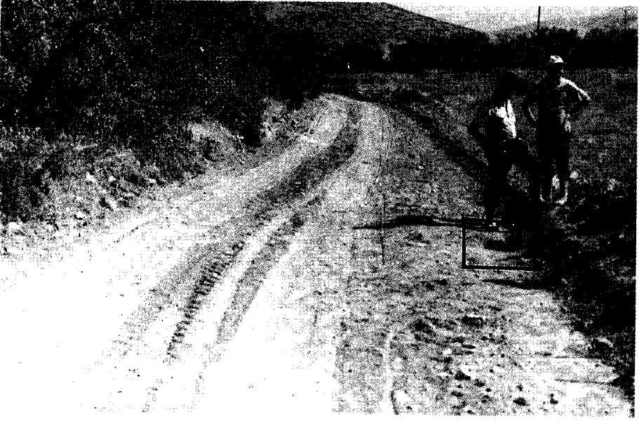
Resim 1: Yol çalışması sırasında mezarın çöken tavan kısmının görünümü
