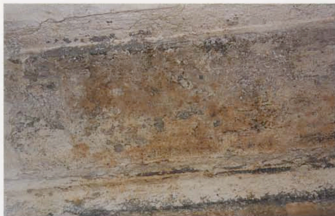
21 – TRACCE DI MANUTENZIONI PREGRESSE SUL TRAVERTINO DOPO L'INTERVENTO DI PULITURA E IL TRATTAMENTO DI PROTEZIONE
