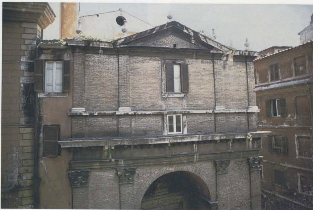
19 – STATO DI ALTERAZIONE SUPERFICIALE DELLA PARTE SUPERIORE DELLA FACCIATA (foto dell'Autrice, 1999)
