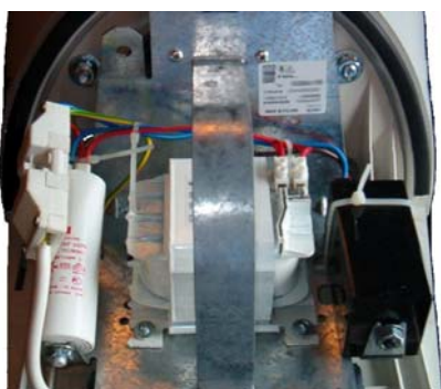
Rys. 5. Wnętrze komory zapłonowej oprawy ulicznej z przewodami z rys. 4
