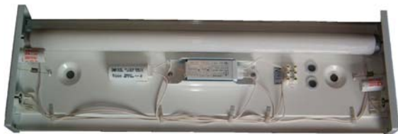
Rys. 3. Wnętrze oprawy świetlówkowej z przewodami DY
