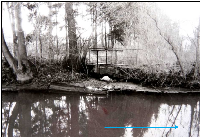
Stavidlo na kanálu u Čeperky v km 3,930 odkud vycházela tzv. „Velká strouha“ k napouštění perněstějnského rybníku Jezero, foto Chudý- 2003.
