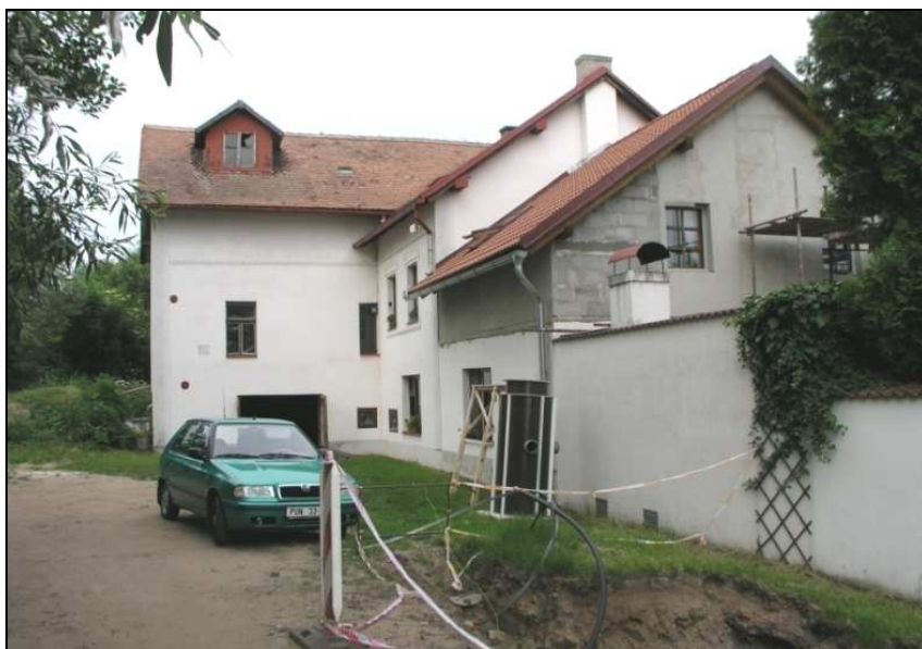
Současný objekt Petrova mlýna, který byl rekonstruován a je trvale obydlen. Reprofota a obrázky na str. 77-82 v červnu 2008 zhotovil Josef Půlpán.
