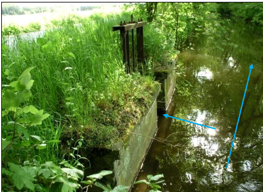
Km 5,930 stavídlo pro strouhu na rybníky „Morčáky“ a louky v „Oboře“.
