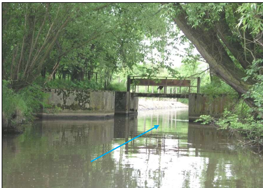
Dnes nefunkční stavidlo na kanálu poblíž železniční vlečky. V pozadí za stavidlem na levém břehu je vidět vývařiště. Foto J.Půlpán.
