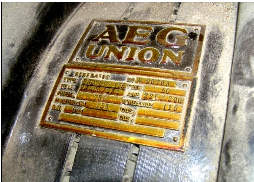
Detail štítku elektrického generátoru.
