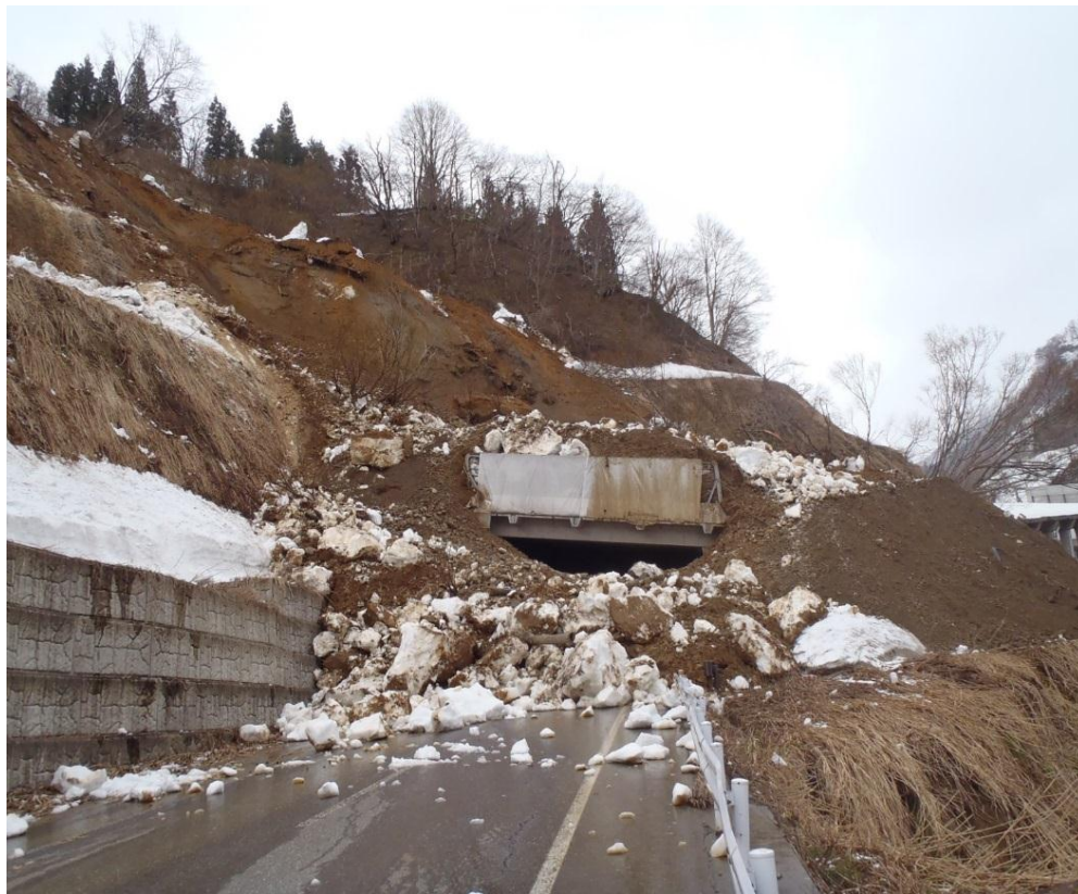
土砂崩落直後の猿倉スノーシェッド（平成26年4月5日撮影）
