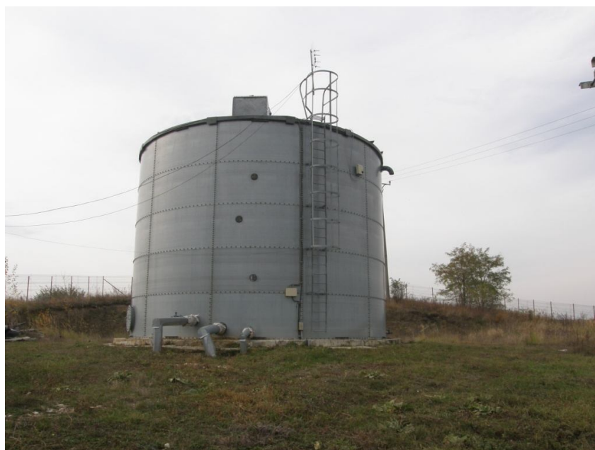
Rezervor de înmagazinare
