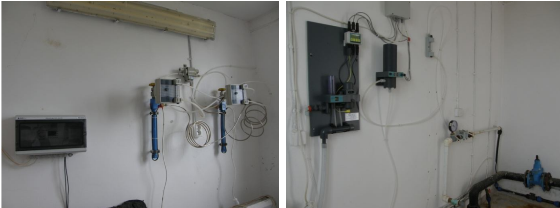
Stația de clorinare
