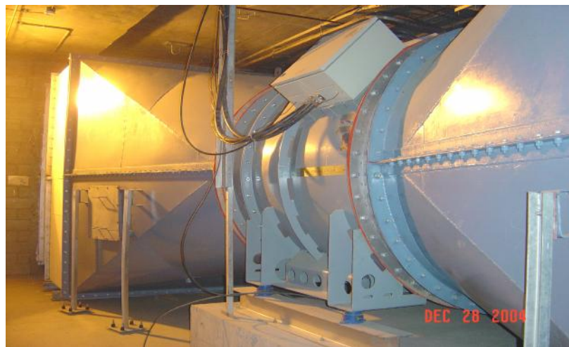
Tunnel Ventilation Fan
