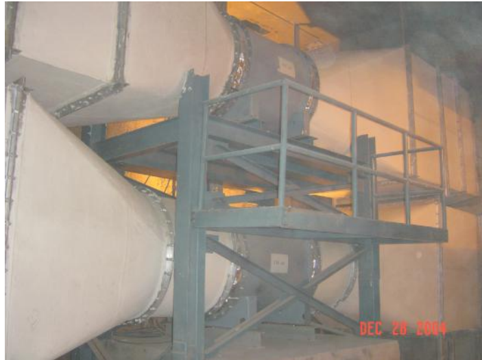
Trackway Exhaust Fan
