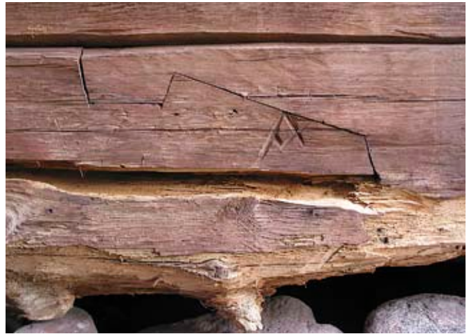
Hirren jatko kohta ja puumerkki. Seinän alin hirsi on pinnoitetaan la-honnut, mutta ehyt ydinosa jätettiin kuitenkin jäljelle.
