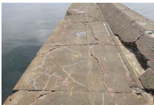
老朽化が著しい外郭施設（室蘭港）
