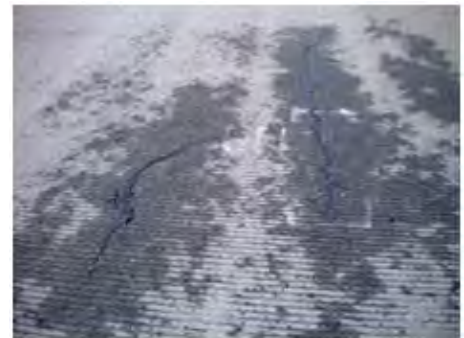
既設誘導路舗装の劣化状況
