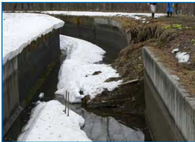
用水路側壁の倒壊
