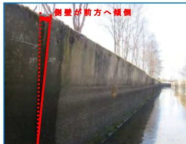
用水路側壁の傾壊
