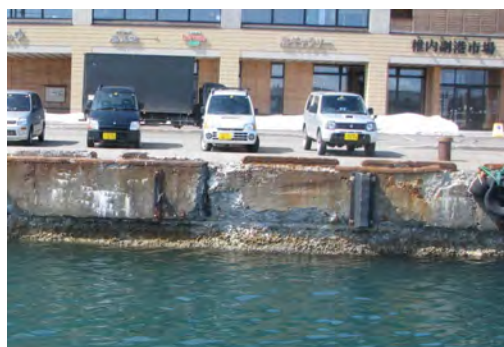
老朽化が著しい係留施設（稚内港）
