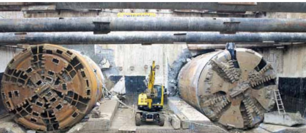
Будівництво Куренівсько-Червоноармійської лінії метро в Києві. Завершено проходку тунелів, механізовані прохідницькі комплекси Wirth і Herrenknecht вийшли у котлован станції
