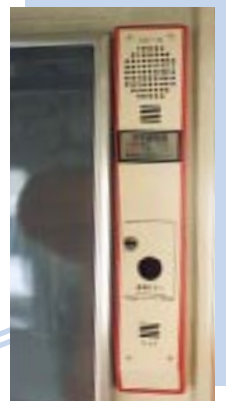
車内非常通報器
