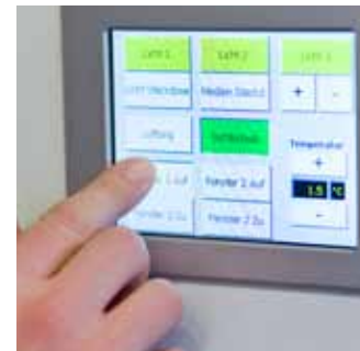
Unkomplizierte Bedienungsmöglichkeiten sind das A und O einer sinnvollen Gebäudeautomation. Hier: Bedienung über einen Touchscreen.
