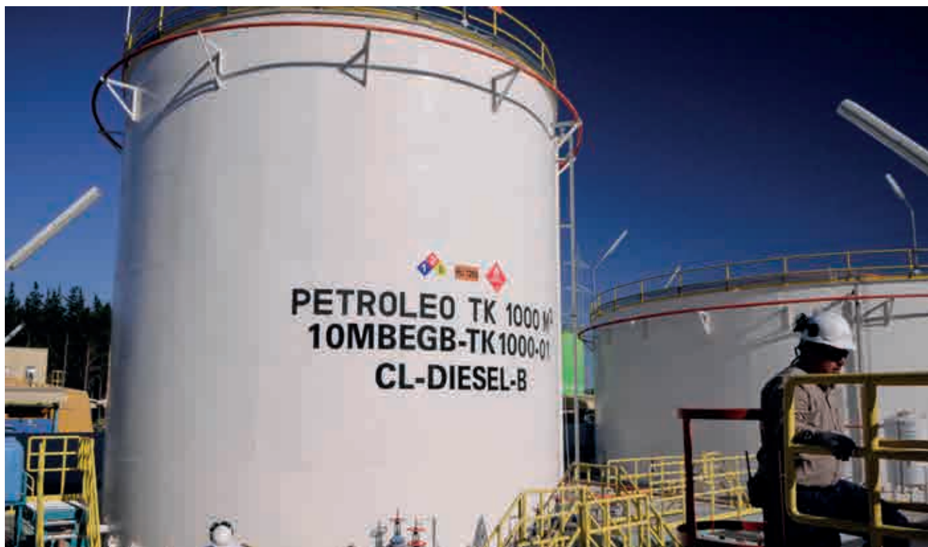
Los Pinos Power Plant
