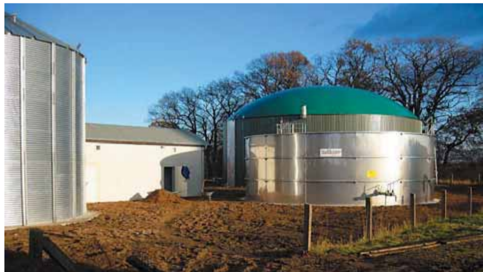
Aus dieser Biogas-Anlage und einem zusätzlichen Holzkessel bezieht eine Gemeinde einen Großteil ihres Energiebedarfs
