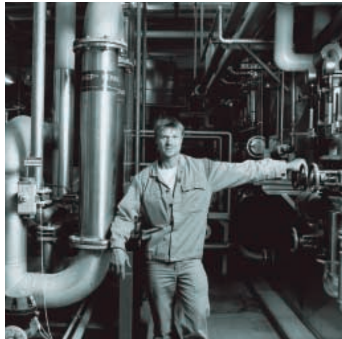
Waschwasser-Recyclinganlage, Mathias Dalfuß
