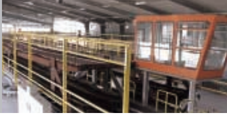
Transportoptimierung durch Einsatz der Schiebebühnentechnik im Werk Emden in Kombination mit systemgestützter Abstellorganisation
