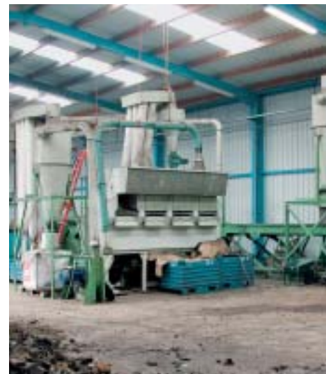
Anlage zur Aufbereitung von Schredderrückständen
