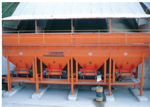
Figura 8.5 Exemplo de estoques e silos cobertos para proteção dos materiais de uma usina gravimétrica
