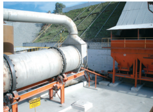
(b) Secador de agregados com ventilador de exaustão
