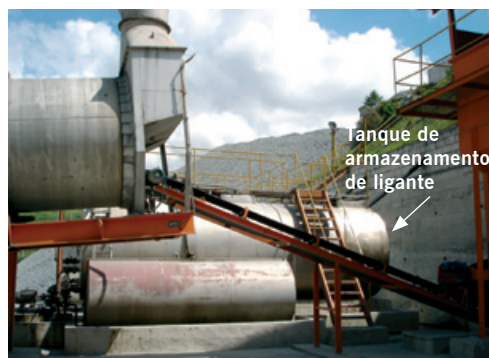
Figura 8.6 Exemplo de tanques horizontais para armazenamento com aquecimento de ligantes asfálticos de uma usina gravimétrica
