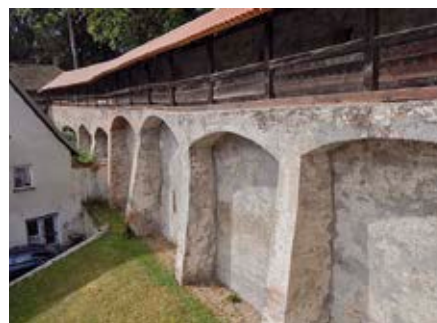
Mauerpartie an der „Hohen Wacht“, mit teilweise erhaltenem Wehrgang des 14. Jahrhunderts (Foto: Barthel & Maus)
