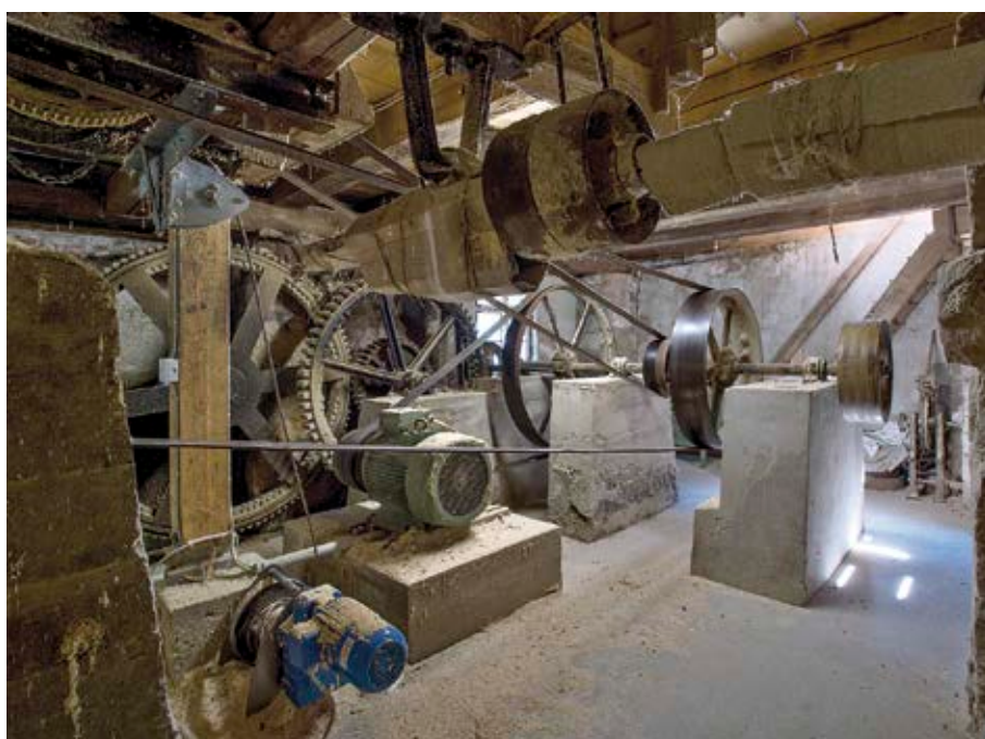
Transmission im sog. Gatterkeller; an der Wand Holzzahnräder zum Antrieb vom Mühlrad her
