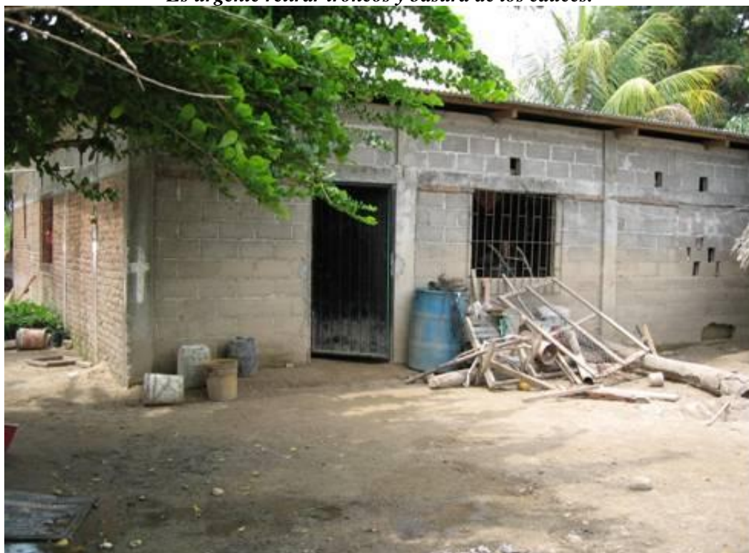
Fotografía 2.33.- Afectación a viviendas por el desbordamiento del río Coatán, poblado Chuniapa.
