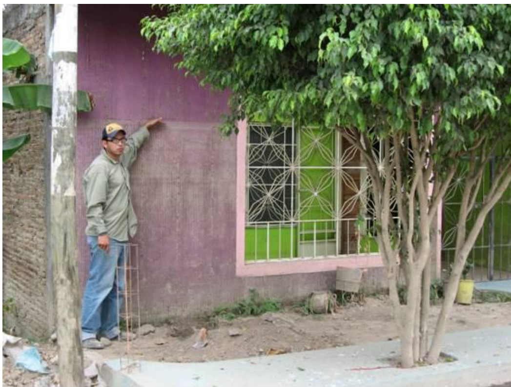
Fotografía 2.9.- Calle Belisario Domínguez entre Díaz Ordaz y Miguel Hidalgo, Barrio Esquipulas. Marcas de inundación en las paredes de viviendas ubicadas dentro del cauce del arroyo Seco. El nivel de agua alcanzó 1.85 m de altura durante la creciente.
