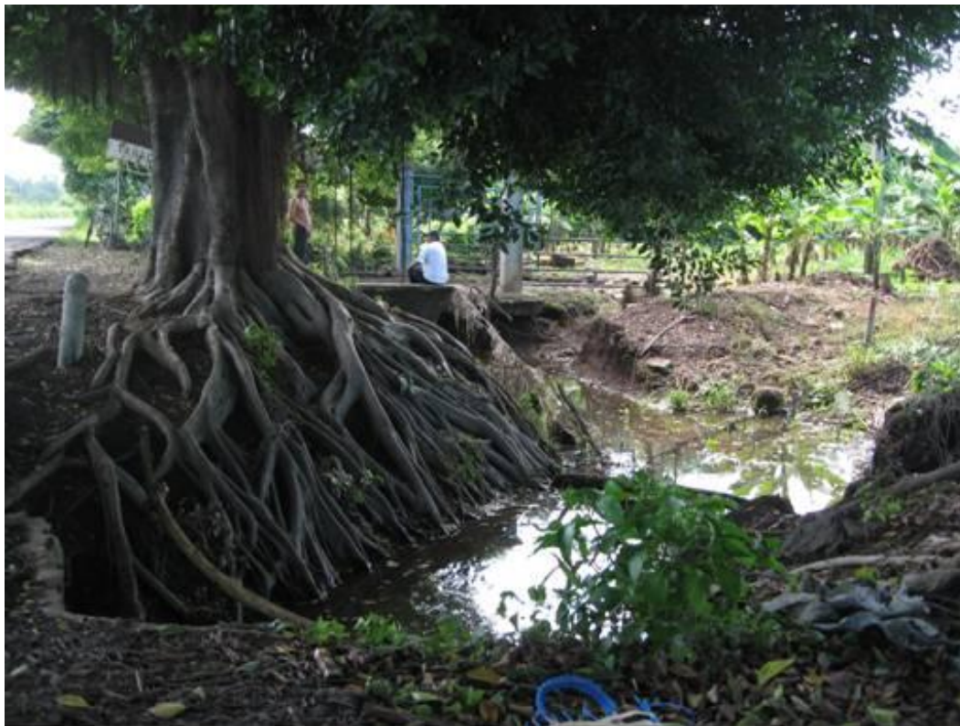
Fotografía 2.28.- Punto INMZ105 obstrucción de obras de drenaje con afectación a vías de comunicación.
