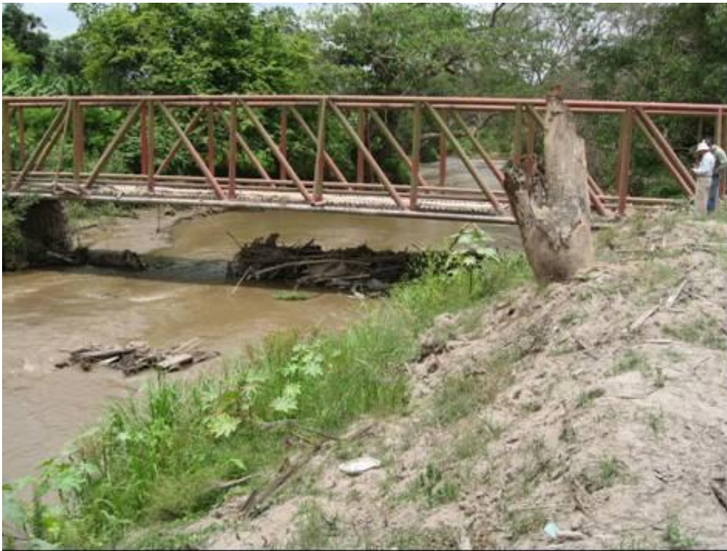
Fotografía 2.31.- Los troncos y ramas arrastradas por la corriente pueden ocasionar bloqueo del libre flujo de agua y generar un desbordamiento del río.
