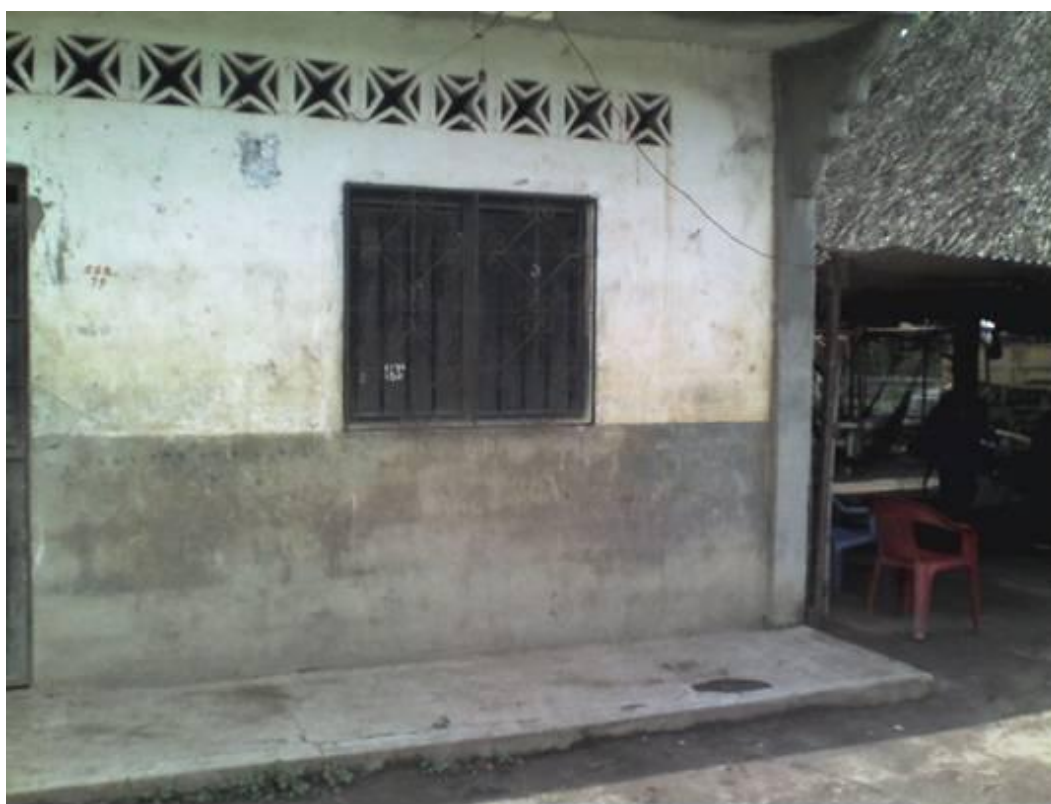
Fotografía 2.26.- Localidad de Adolfo López Mateos, se observan las marcas de agua y lodo alcanzadas con la inundación del 2005.
