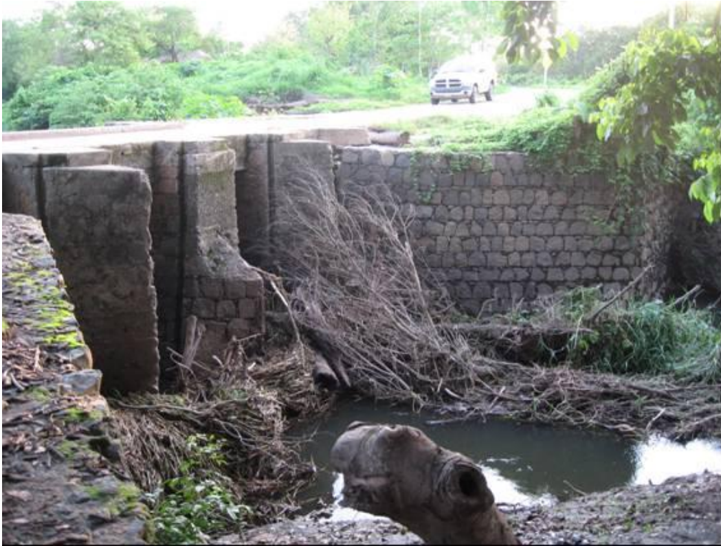
Fotografía 2.35.- Se observó asolvamiento en el río Las Latas además de gran cantidad de residuos sólidos urbanos, el puente muestra daño en sus pilares.
