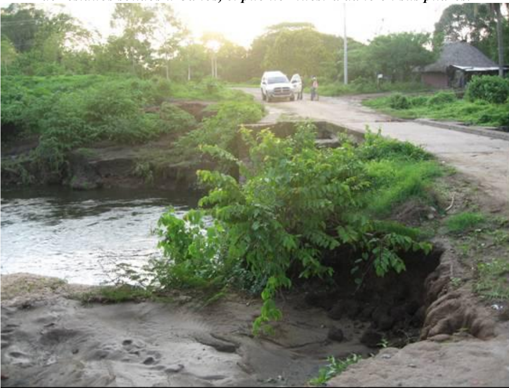
Fotografía 2.36.- Viviendas cercanas al río en peligro de inundación, localidad Las Varillas.
