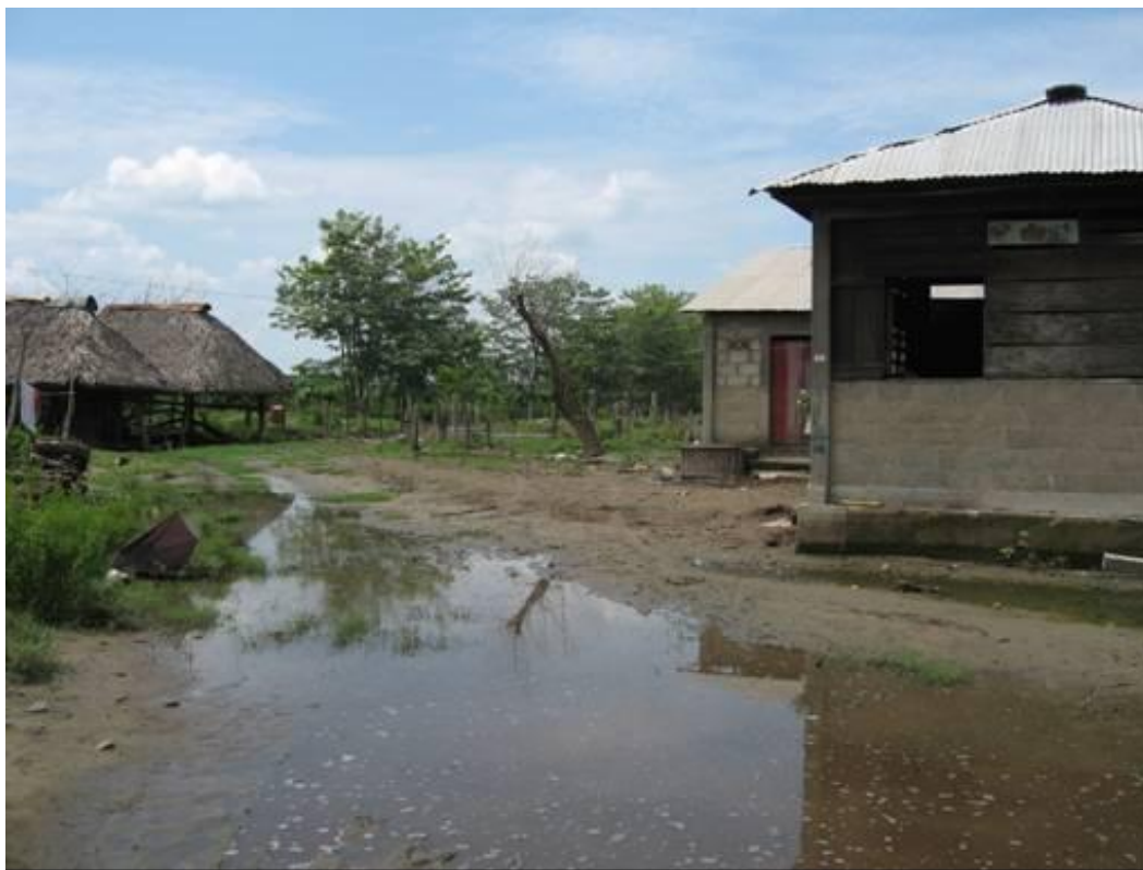
Fotografía 2.34.- Actualmente se observa encharcamiento de agua en el terreno y las viviendas siguen mostrando los daños ocasionados por el desborde del Coatán.
