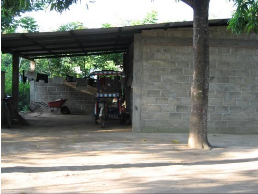
Fotografía 2.20.- Cerrada Altamirano poniente, Barrio Guadalupe, nivel máximo alcanzado, 0.40 m. las viviendas presentan fracturas después de la inundación debido al asentamiento del terreno compuesto por arcillas y limos.
