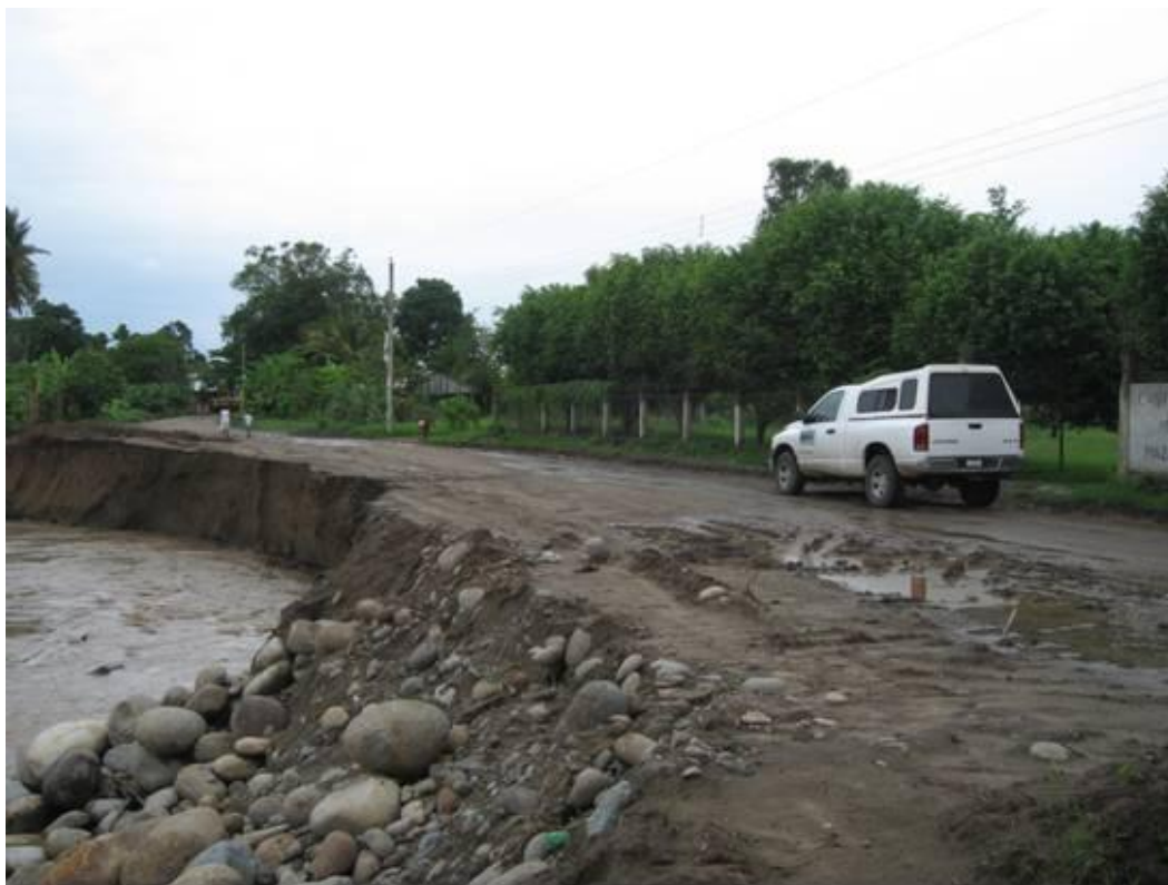
Fotografía 2.2.- Río Coatán a la altura del Cantón El Triunfo. Observe el desgaste del margen derecho del río, al frente se asocia con erosión hídrica laminar de grado débil (Eh1) y erosión antrópica por crecimiento urbano (Ea1).
