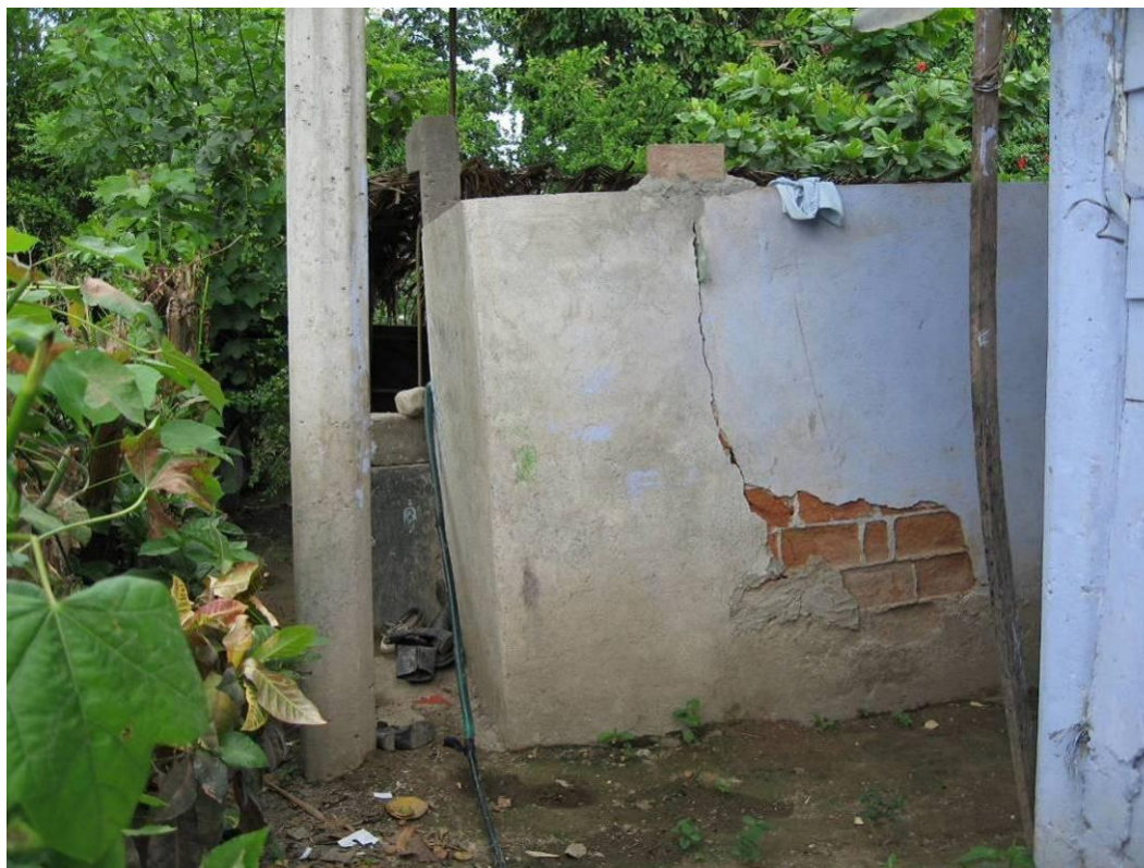
Fotografía 2.21.- Asentamiento del terreno por saturación de agua con afectación a viviendas y colapso de algunos pozos (INMZ068).
