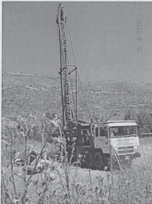
Construcción de nuevos pozos para el abastecimiento de agua subterránea en la zona de Valdetales, en las inmediaciones del río Jarama (a unos 200 m. de la ribera). Junio, 2013.
