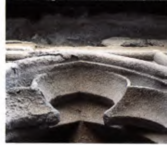
2 Steinschäden am gotischen Maßwerk der Westfassade.
