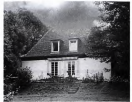
Der Zustand heute, der Putz ist abgängig, das Gebälk hat Wasser gezogen.
