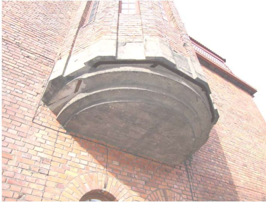
37. Peafassaadi parema ärkli betoonplaat ja selle kahjustatud sarrus.
