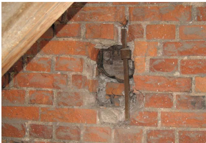
69. Tornihulekahjus kannatanud sisepind ja katmata tala-ankru ots.
