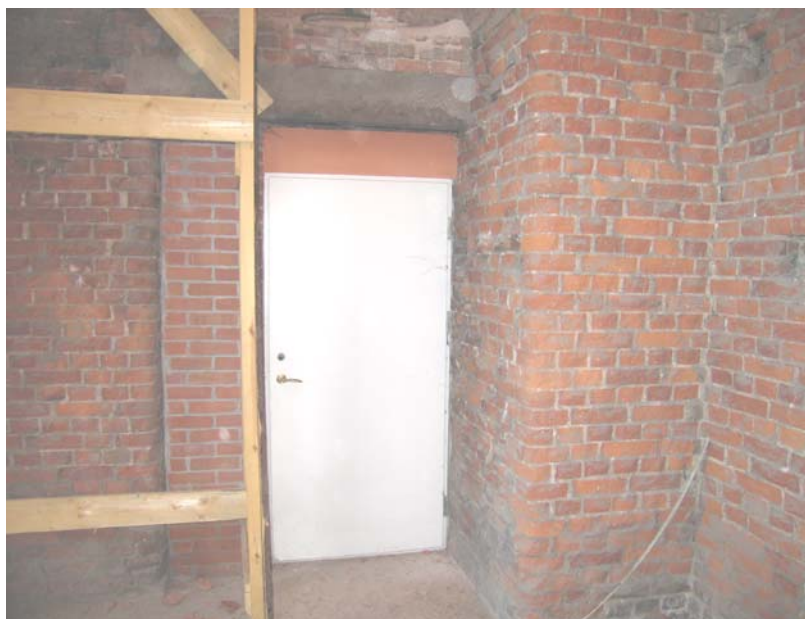
66. Torniruumi algupärane uks on vahetatud väiksema vastu.
