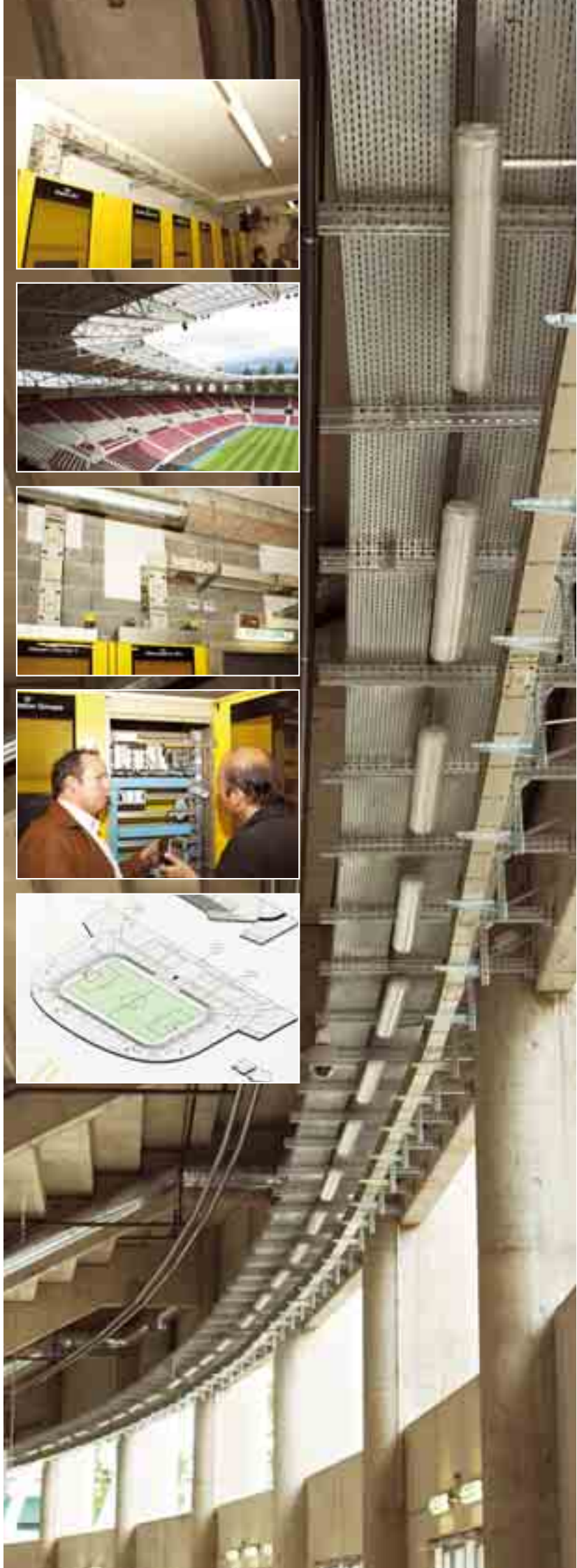
(de haut en bas) Armoires de répartition Prisma, barres Canalis Eclairage optimal sans poteaux à projecteurs Liaison TGBT-canalisation électriques Philippe Benguerel et Walmar Isler devant une armoire de répartition
