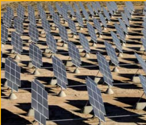
Nellis Air Force Base - 14 MW - Nevada, USA
