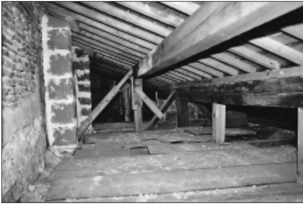
FIG. 18. DEUXIÈME ÉTAGE DU CORPS-ARRIÈRE (B). Vestiges de la charpente apparente (panne faitière à gauche). Cliché Frédéric Messager, HADÈS.
