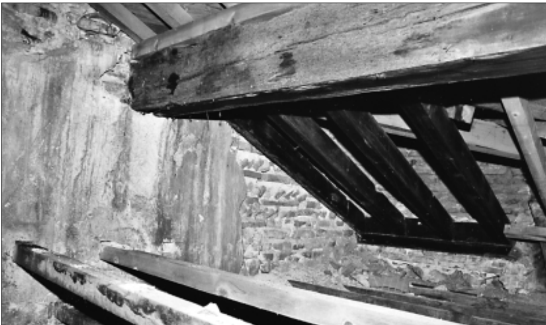
FIG. 28. CHARPENTE APPARENTE AU SECOND ÉTAGE DU CORPS ARRIÈRE. Détail. Cliché Frédéric Messager, HADES.
