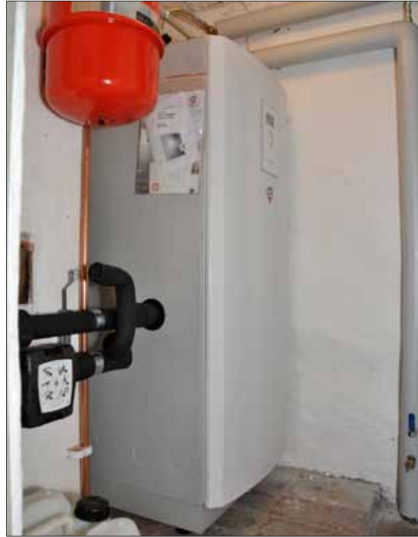
12 Bergvärmeinstallationerna i kyrkans pannrum (Slm D12-0667).
