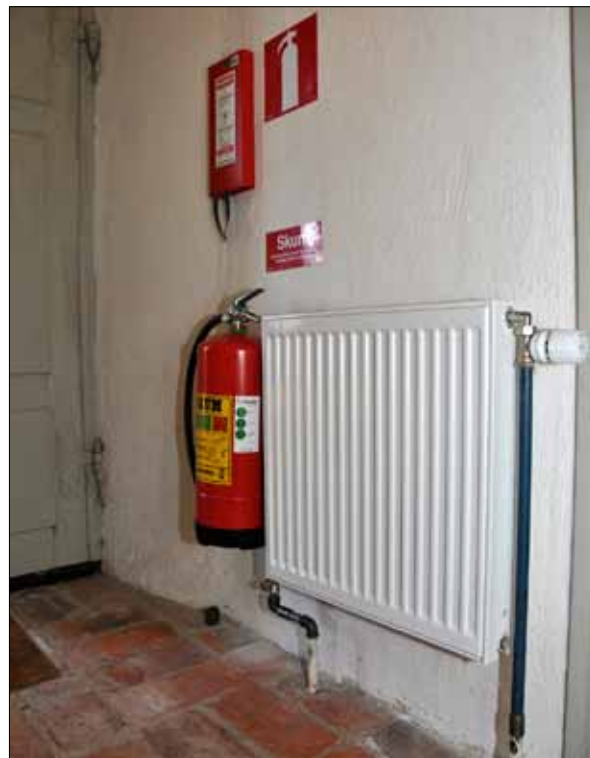
14 Den nya radiatoren är bättre anpassad till rummet (Slm D12-0669).
