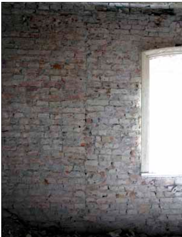
27 Vertikal stötfog i västra väggens murverk, från öster, 20070927 (Slm D09-678).
