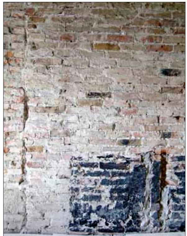
93 Spår efter en murad nisch på den östra väggen, 20070927 (Slm D09-735).
