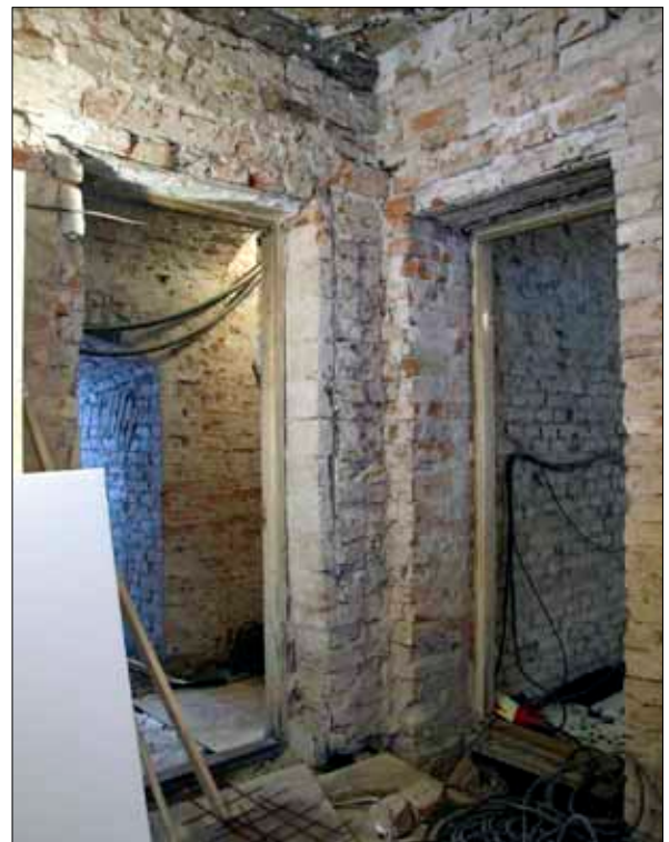
45 Dörröppningarna mellan rum 106 och 107, t v, och 104, t h, från nordost, 20080207 (Slm D09-694).
