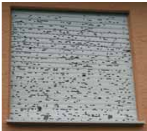
Abbildung 18: Hagelkörner werden durch Windböen oft auch horizontal beschleunigt und bewirken so Schäden unter anderem an Rolläden wie hier nach einem Hagelunwetter am 08.07.2004 in Stockach (Quelle: J. Braun, Stockach).
