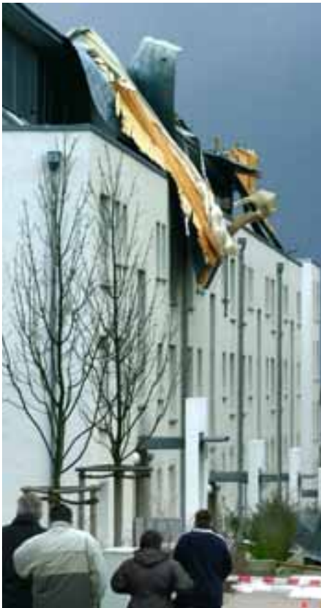
Durch den Orkan ANNA zerstörtes Pultdach in Hannover (Quelle: dpa)
