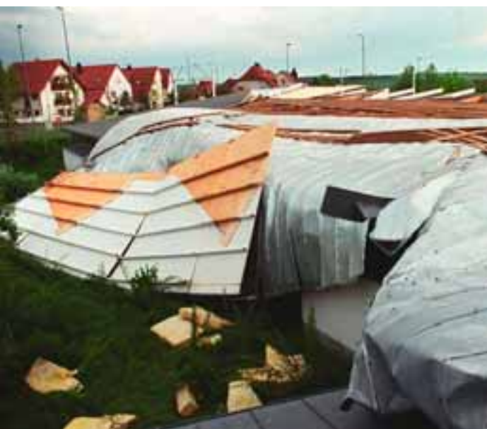
Abbildung 16: Abgewehtes Pultdach einer Schule in einem Neubaugebiet
