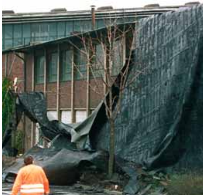
Vom Sturm heruntergewehte Dachpappe einer Lagerhalle in Dortmund am 04.03.1998 (Quelle: dpa)
