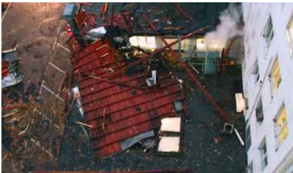
Durch den Sturm JEANETTE herabgewehte Dachteile in Forchheim/Bayern (Quelle: THW Forchheim)
