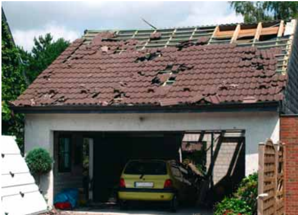
Abbildung 15: Typische Sturmschäden im Leebereich von Dachfirst und Ortgang
