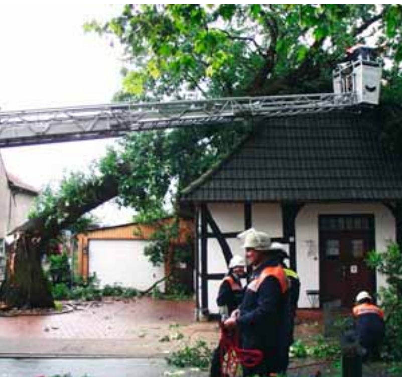
Durch eine umgestürzte Eiche zerstörtes Dach nach einem Unwetter im Juni 1998 (Quelle: C. Weber, Minden)
