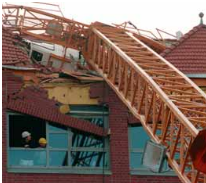
Sturm DANIELA ließ am 21.02.1997 einen Baukran auf das Dach eines Krankenhauses in Köln-Niehl stürzen (Quelle: dpa).
