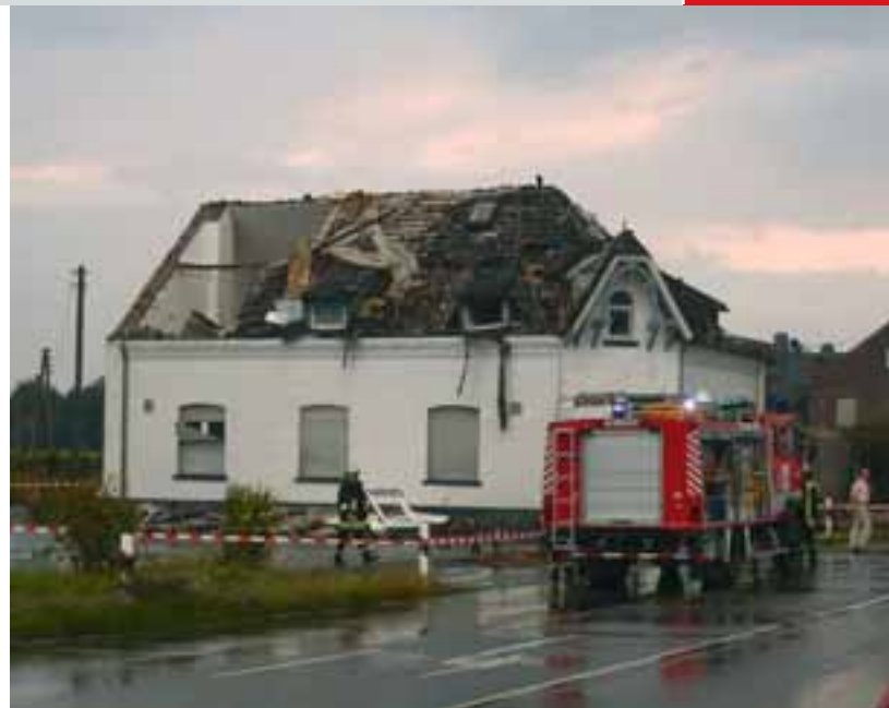
...verursachte einige extreme Gebäudeschäden (Quelle: K. Kremers, Tönisvorst).
