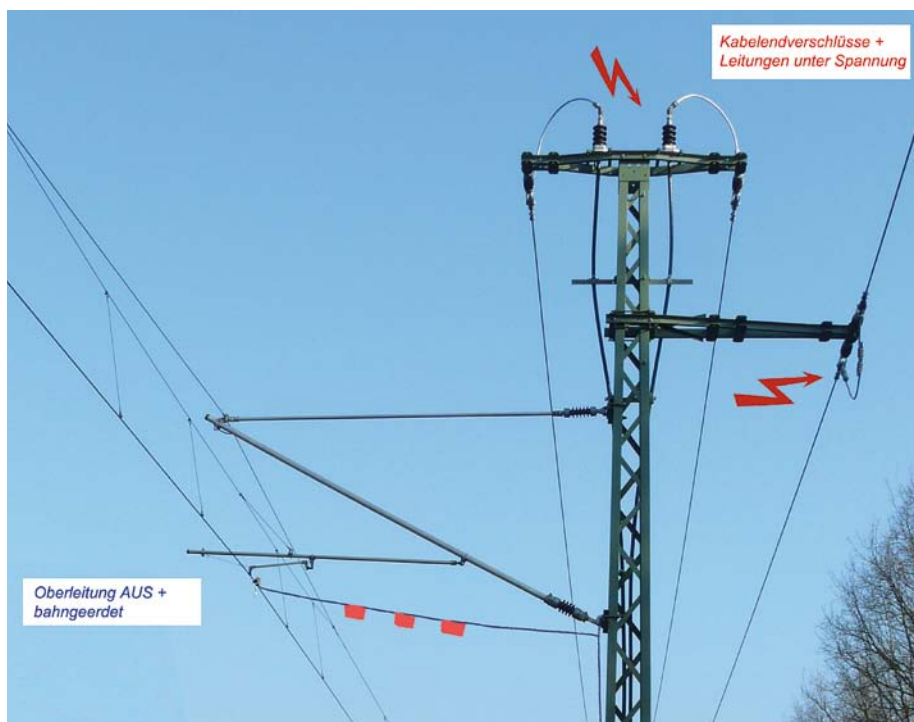
Abbildung 8: Unter Spannung stehende Teile trotz geerdeter Oberleitung
